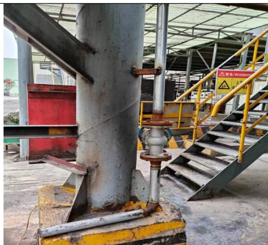
蒸汽冷凝水排水管
