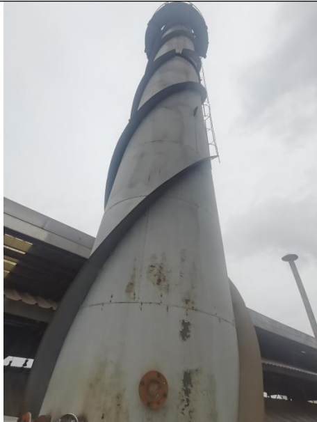
罩式退火炉和台车式固熔炉排气筒 G3
